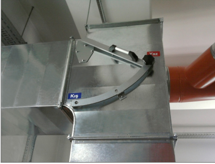
Geri dönüşüm klapesi ile birlikte fabrika atık ısıyla kışın fabrika ısıtması sağlanan EN-GE uygulaması
