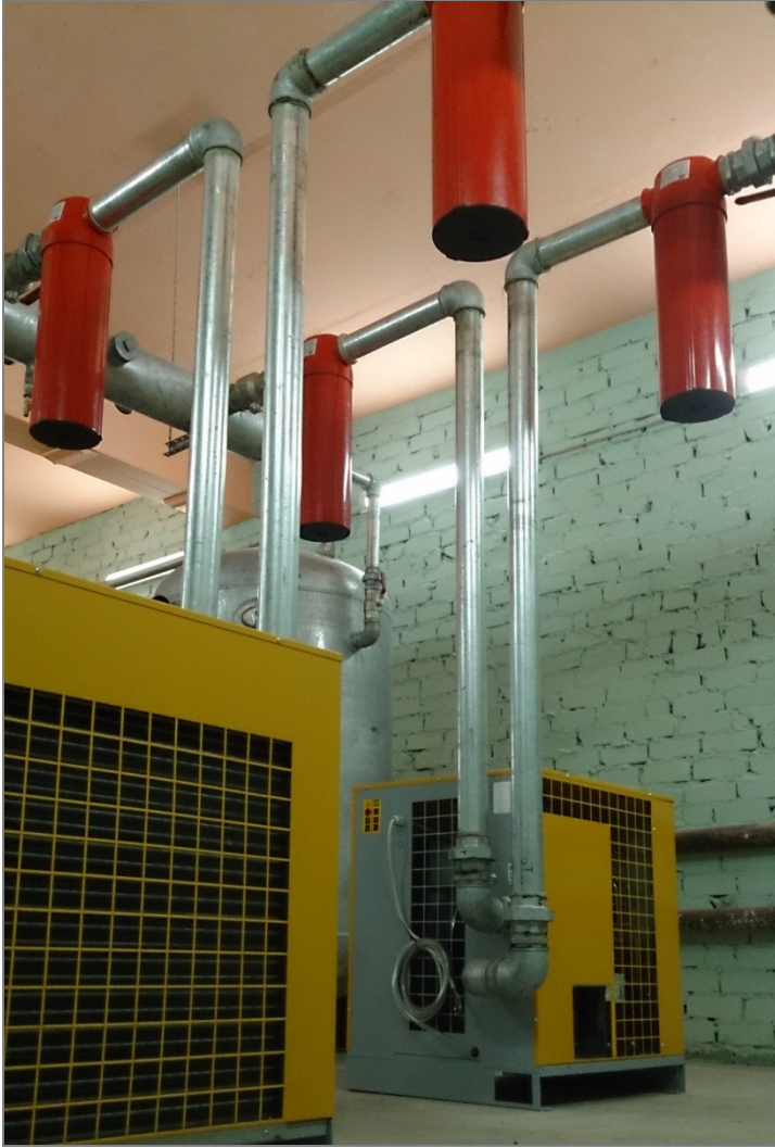
Seperatör kollektörlerle düzenli, uzun ömürlü ve az bakım gerektiren kompresör daireleri
