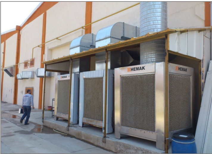
Klima Sistemi (HVAC)
