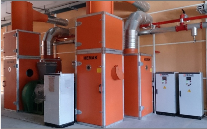
Briket haline getirilen firelerin az yer kapladığı, temiz ve düzenli fan-filtre odaları
