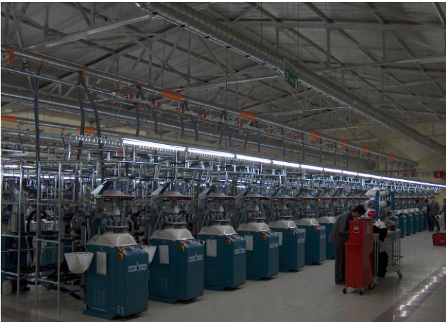
Örgü holü evaporatif klima uygulaması
