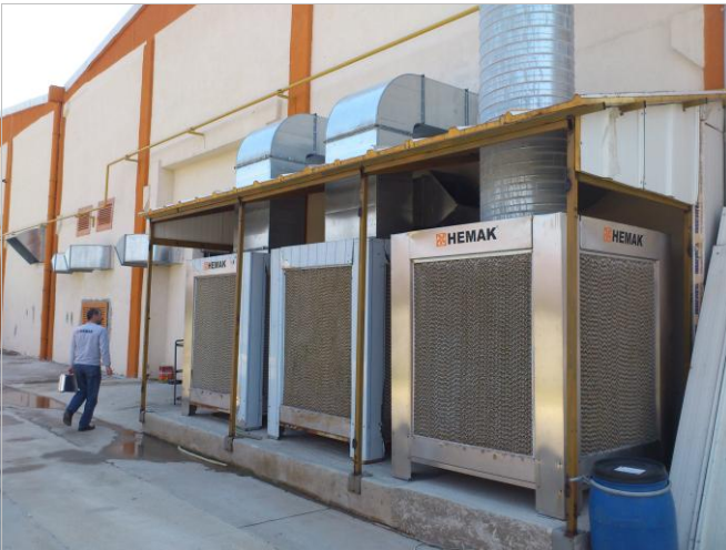
Evaporatif klima grup uygulaması
